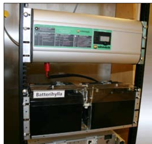
BAS 19" med monterad batterihylla i 19" stativ.
